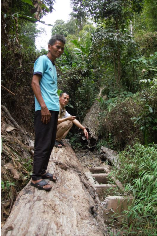
Destruction du captage par la chute d'un arbre
